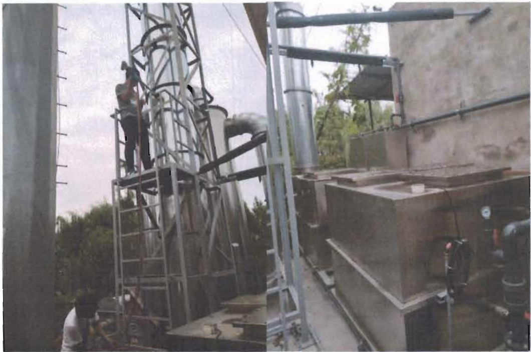
图 7.1-1 废气处理设备
